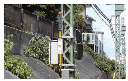
▲落石検知装置
