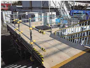
①久里浜工場にホームドアを搬入するための特設スロープを設置
